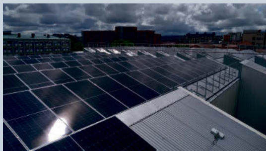
Hospital Clínico Universitario de Valladolid
